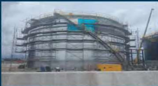
Aislamiento térmico con enchaquetamiento
